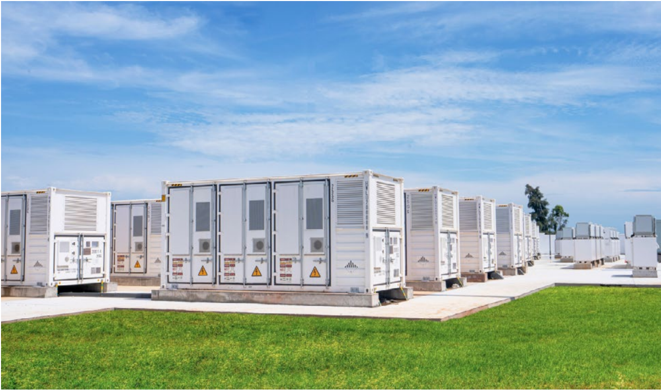
华为助力大唐在海南文昌建设的“农光互补+储能”项目
